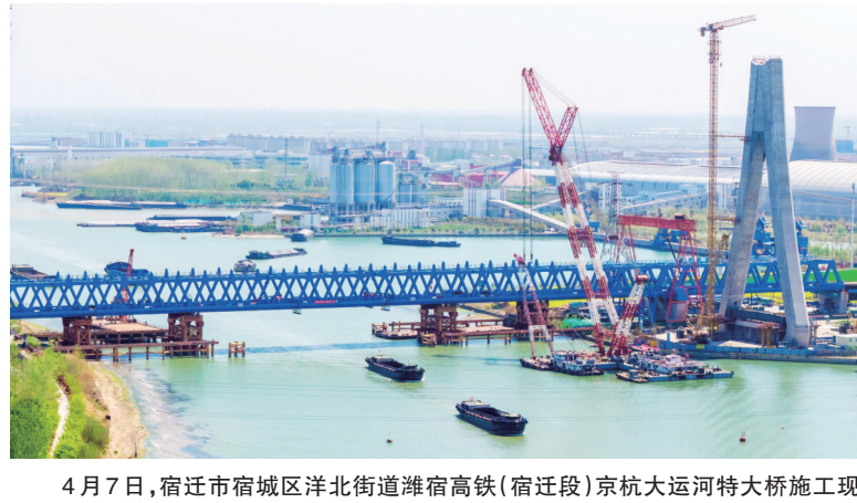
4月7日，宿迁市宿城区区北街道宿淮高铁（宿迁段）京杭大运河特大桥施工现场，工人们利用晴好天气各司其职加紧施工、有序作业。徐瑞摄
