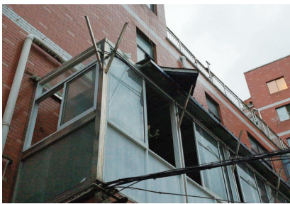
7月7日18时54分，镇江市消防救援支队指挥中心接到群众报警，大路镇一处临时搭建房屋的彩钢瓦被狂风吹开，悬于半空，存在高空坠物伤人的风险。接警后，119指挥中心立即调派辖区消防救援人员赶赴现场处置。消防救援人员迅速抵达现场，经现场环境制定处置方案，通过窗户安全进入室内，从内部将悬空彩钢瓦平稳推落，成功排除高空坠物隐患。 朱珏或 陆 鑫 摄
