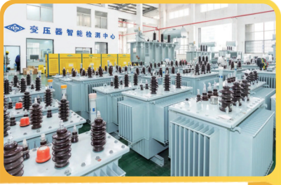
光辉变压器生产车间。姚 晗 摄
