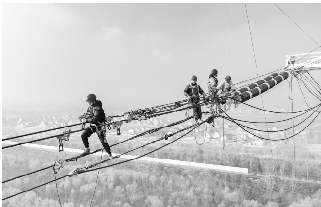
3月25日,在三汉湾—龙王山500千伏线路升高改造工程现场,江苏省送变电有限公司施工人员跨越G2503绕越高速架设导线。据了解,本次升高改造共组立新铁塔1基,拆除旧铁塔1基。
