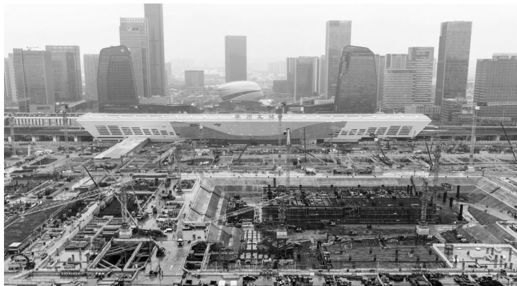
4月12日,春雨绵绵,高铁苏州北站综合枢纽工程建设现场一派繁忙。施工人员抢抓工期,冒雨奋战、加紧作业,全力推进项目建设,确保工程节点有序落地。孔繁立 摄 视觉江苏网供图
