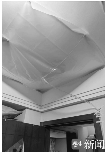
在天花板铺塑料薄膜接漏水,再接上引流管把水导到水桶里
