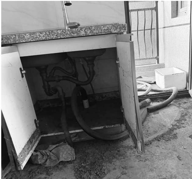
临时管道导致阳台房门难以完全合上
