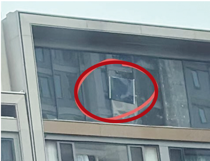
炸裂的玻璃 小区业主提供
