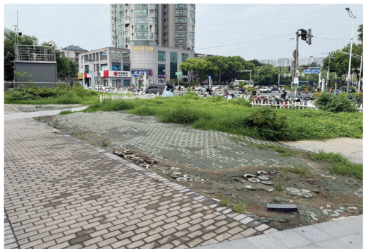
地面坑坑洼洼
