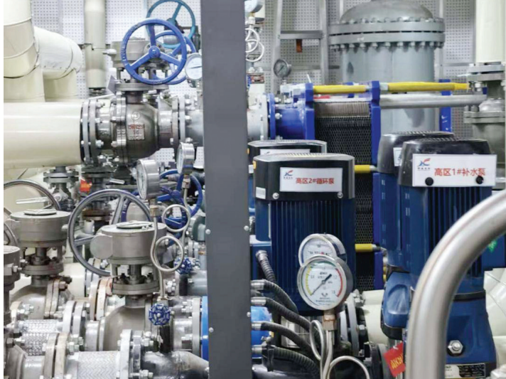
集中供冷项目的机房
