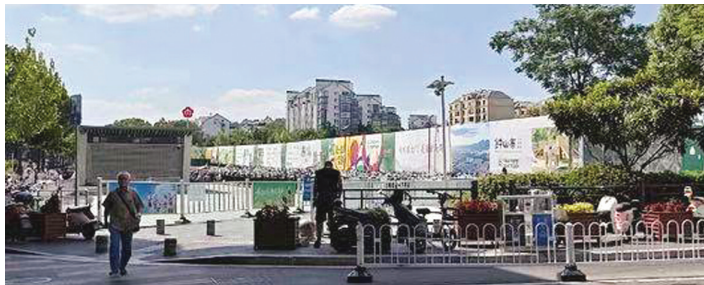
10日,马群地铁站金属围挡已全部覆盖项目宣传画面,裸露反光问题已经消除
